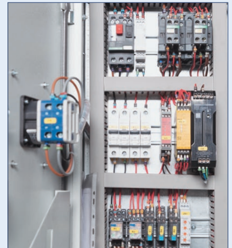
Eine übersichtliche Anordnung der Komponenten erleichtert die Wartung und Fehlersuche
