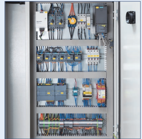
Klare Struktur: Eine übersichtliche Anordnung der Komponenten erleichtert die Wartung und Fehlersuche
