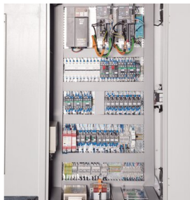
Der große Schaltschrank ist mit hochwertigen Komponenten bestückt
