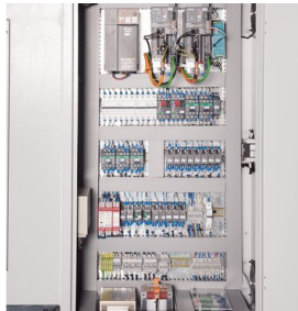
Duża szafa rozdzielcza jest wyposażona w komponenty wysokiej jakości
