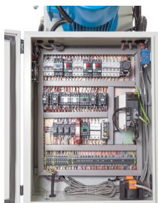
Componentele electrice de înaltă calitate și cablajul curat și structurat minimizează defectiunile
